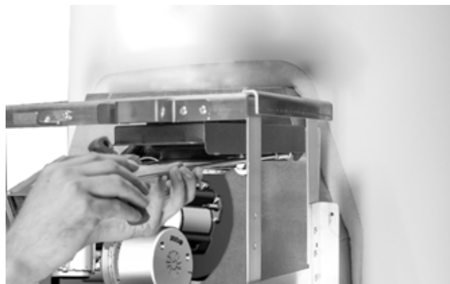
Fig. 37: Serraggio del supporto della tenuta a soffietto
