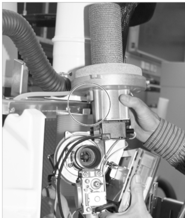
Fig. 109: bruciatore in posizione di manutenzione sulla console
